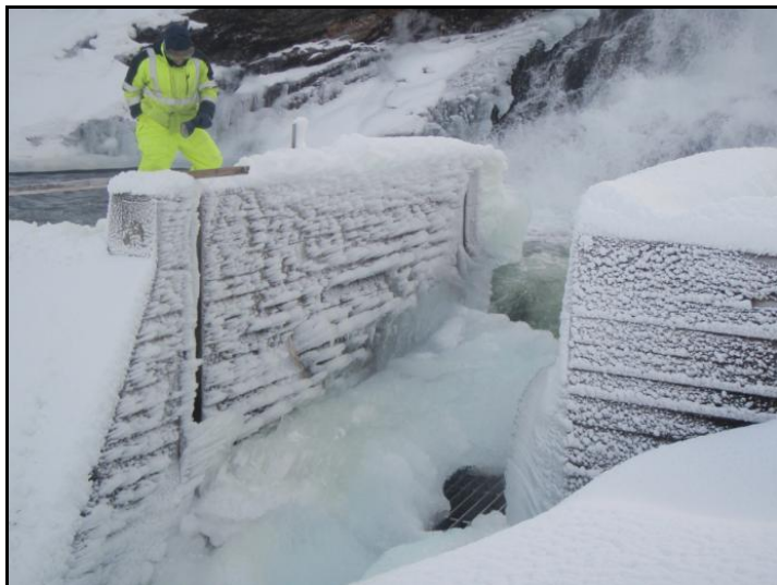
Figur 2.3. Ising på bekkeinntaket
